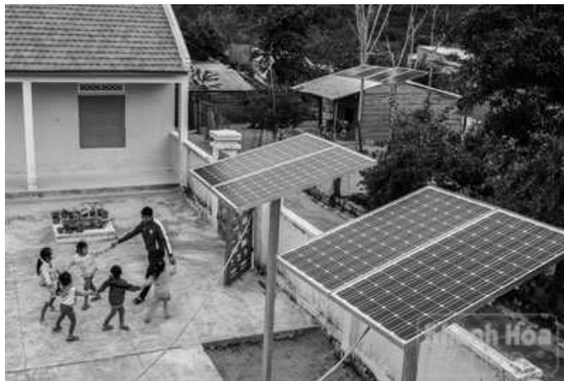
Hình 6.1: Tấm pin NLMT lắp đặt trên đảo Ninh Tân
